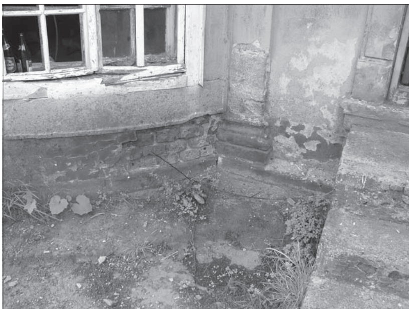
Děčín - zámek, čajový pavilon. Navýšení terénu kolem stavby. Nátěr imitující sokl je dílem Sovětské armády. Schody vedou do nového vstupu - oknem.
