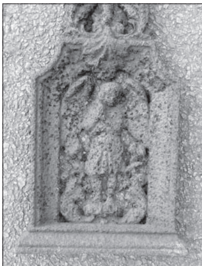
Soklík kříže těžce narušen miskovitou korozi pokrytý nesoudržnou krusťou korozních produktů. Stav řešitelný pouze tryskáním. (Českolipsko)
