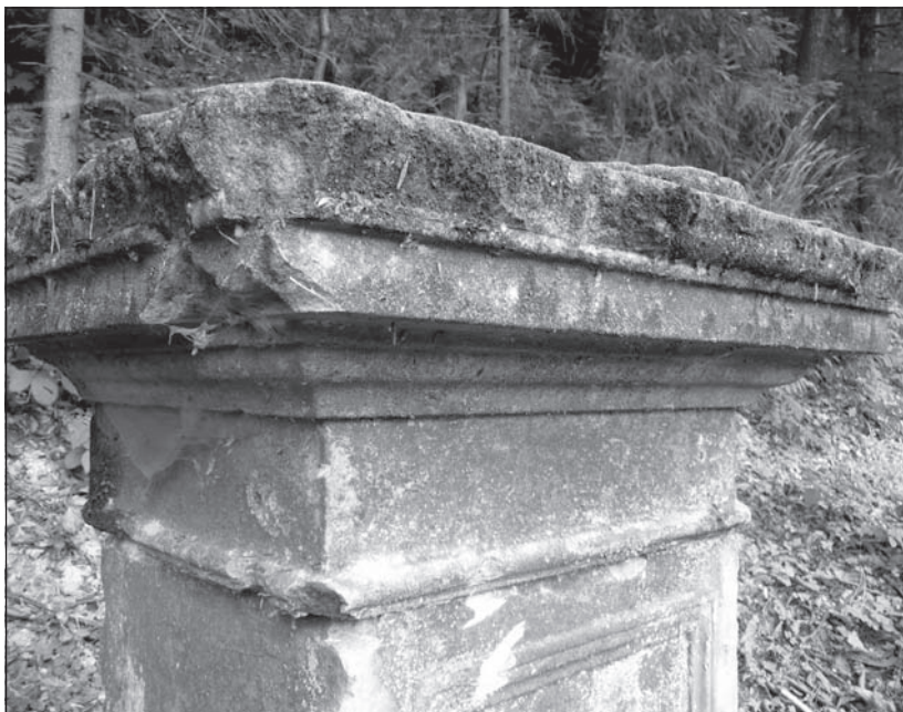
Mechanicky poškozené části římsy
