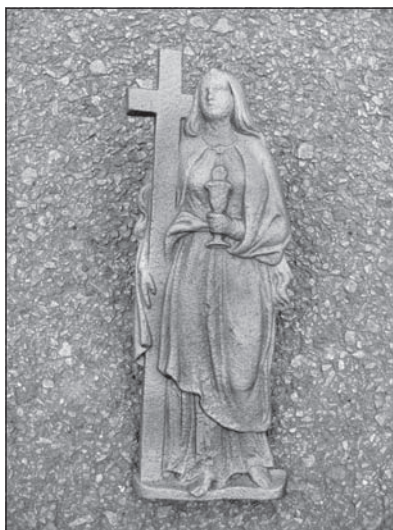
Figurální detail z kříže po vyčištění tryskáním, povrch před čištěním celoplošně narušen korozi.
