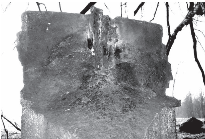
Odlomení římsy božích muk, způsobené korozí zapuštěné části vrcholového kříže
