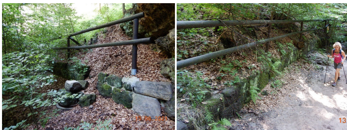
Obrázek 10 – Opěrná zed' OP2 – Typický stav zdi
