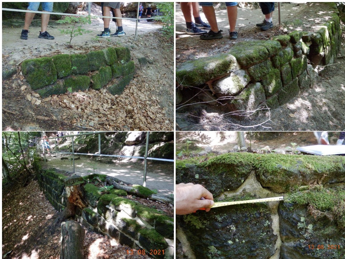
Obrázek 13 – Opěrná zed' OP3 – Typický stav zdi
