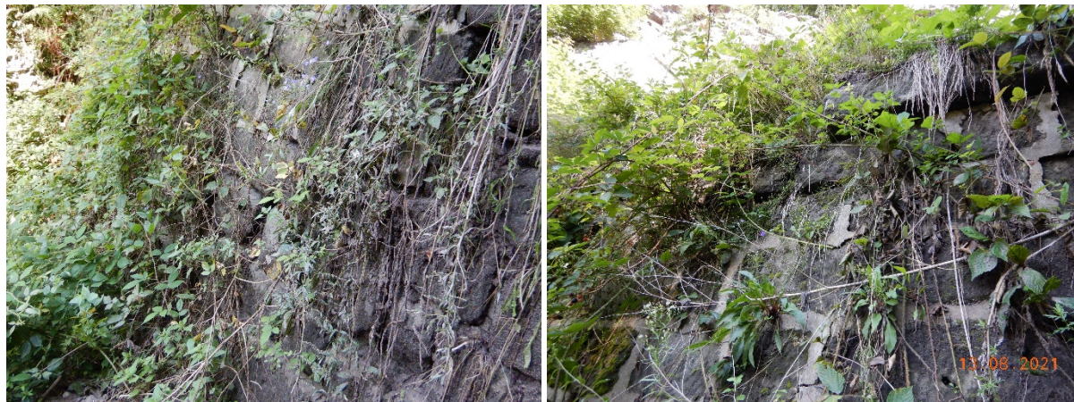
Obrázek 25 – Opěrná zeď OP5 – Typický stav zdi
