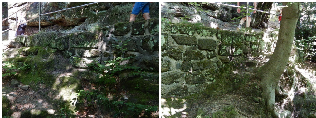
Obrázek 16 – Opěrná zed' OP4 – Typický stav zdi
