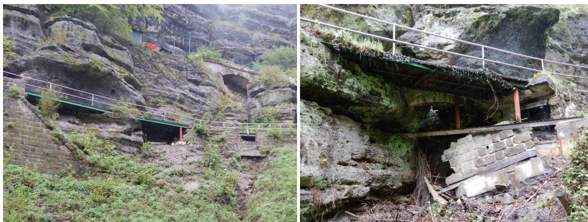
Obrázek 2 – Příklady havarijního stavu jednotlivých objektů (stav k 05/2021)
