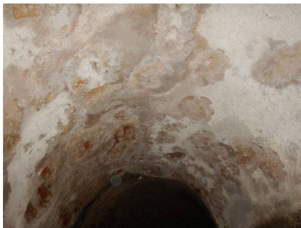
Obrázek 61 – Tunel T1 – Aktuální stav zdiva cihelné klenby na konci staničení
