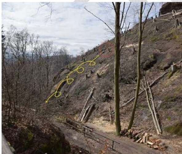
Obr. 13 Při kácení v úseku DD5 byl odhalen skalní objekt v nepříznivé pozici nad stezkou k Pravčické bráně (u serpentýny). Objekt byl operativně odtěžen (samostatná akce SNPČŠ zadaná odborné firmě, bez dokumentace ČGS).
