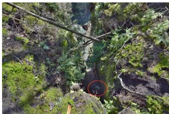
Obr. 22 Zaklíněný skalní objekt níže v puklině nad roubenou stavbou.
