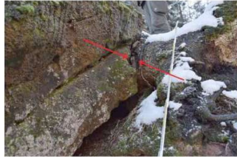
Foto 2 Detail pohled na indikaci pohybu skalního bloku vůči kořenu stromu.
