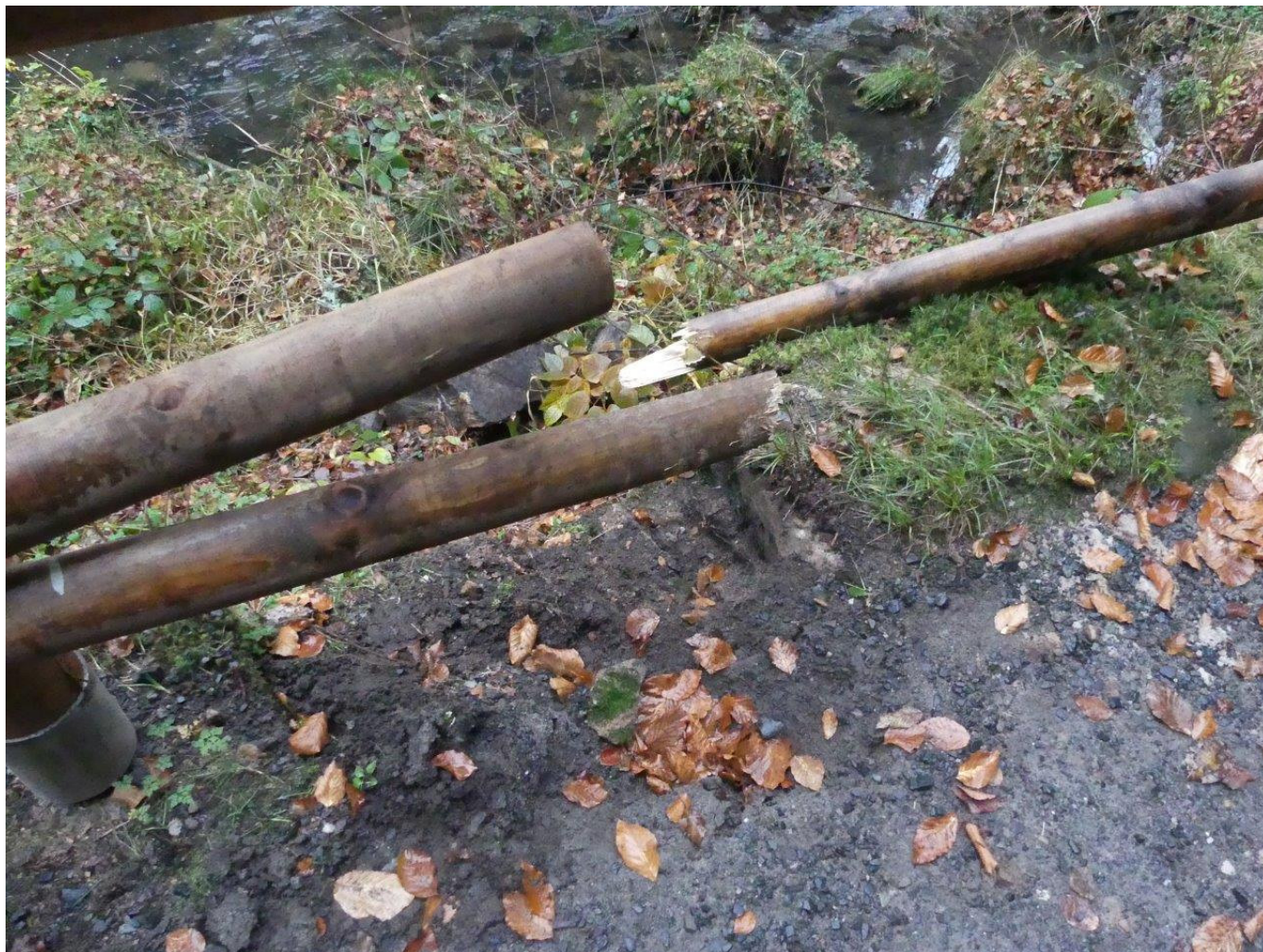
Křmen o hmotnosti cca 50 kg, který spadl po úřádkem tře dne ze svahu Edmundovy soutěsky na cestu, poškodil zábradlí a skončil v korytě Kamenice. Foto: Pavel Svoboda Foto aktuality
