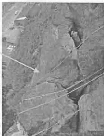
Hřensko 2002: nebezpečný objekt na horní hraně skal, nad budovou free-shopu.
