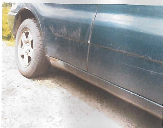
Obr. P3 – Pohled na korozi pravého prahu karosérie a stav laku na pravém boku
