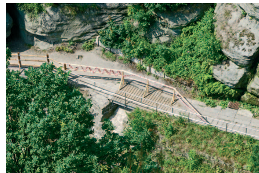
Provizorní řešení v havarijní části přístupu k Pravčické bráně. © Pavel Svoboda
