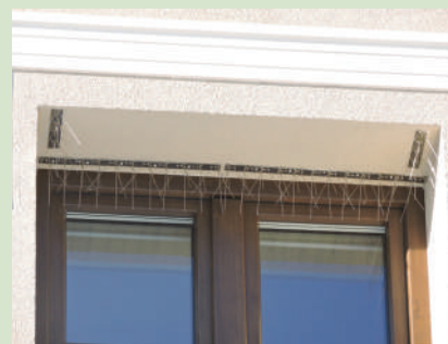
Hroty v oknech nádražní budovy v Rybništi, 2024
